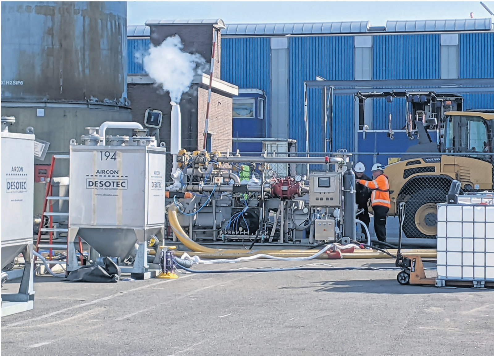
De ontgassingsinstallatie op het terrein in Vlaardingen.
